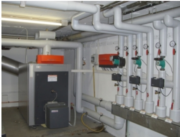
Kessel und Verteilung
