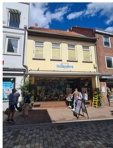
Trotz Denkmalschutz: Überformter EG-Bereich
