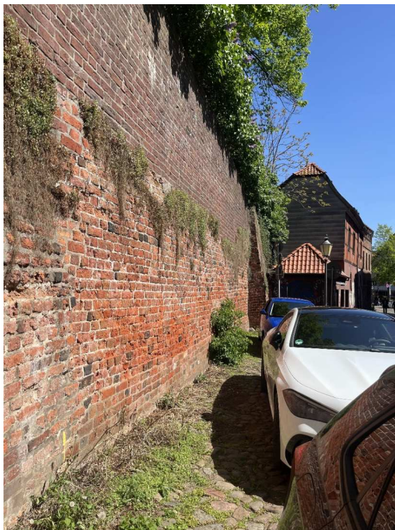
Abb. 45: Bardowicker Mauer im sanierungswürdigen Zustand
