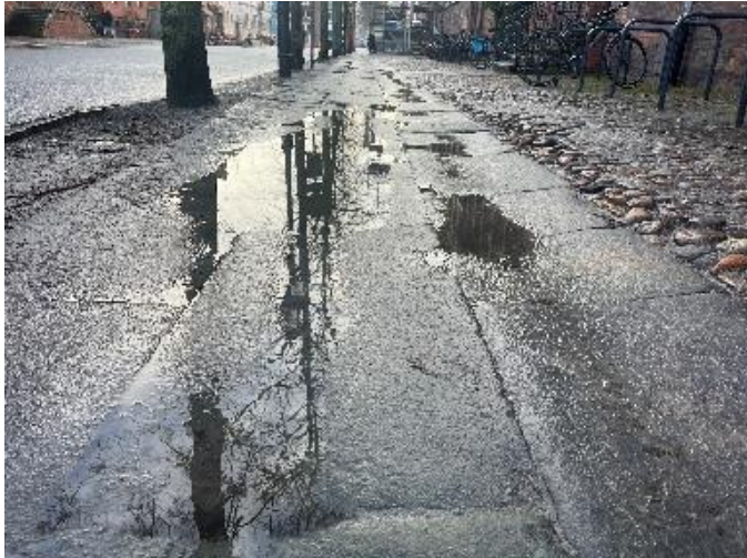
Straßenschäden, Versackungen und Pfützen stellen Hindernisse dar...
