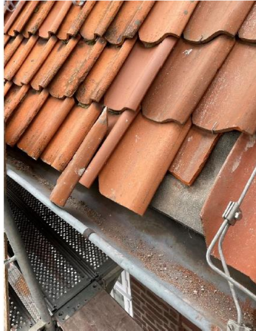
Foto: lose Dachziegel vor Sanierung
